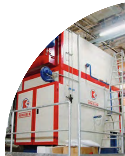
Nowy kocioł na zrębki drzewne, sfinansowany w ramach intractingu Źródło: LHS Stuttgart
